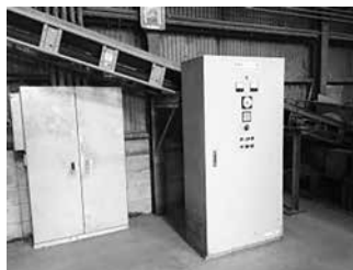
⑩配電盤(インバーター制御) (希望でストルティモーターとセット売却) 1台
