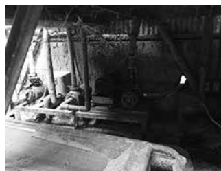
⑧ラジアルベーンポンプ (圧送ポンプ) 1台
