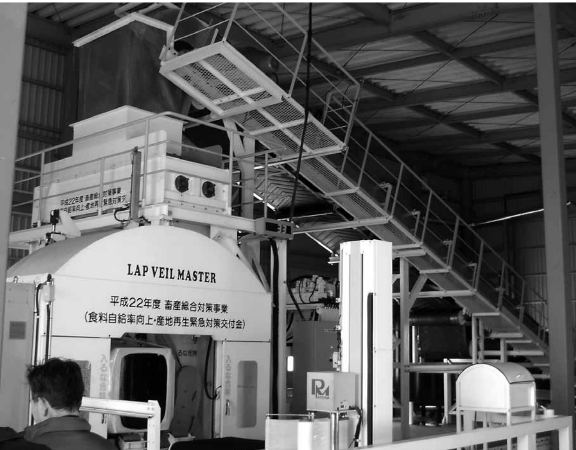
(八代TMRセンター内の製造ライン。左が圧縮梱包機)
