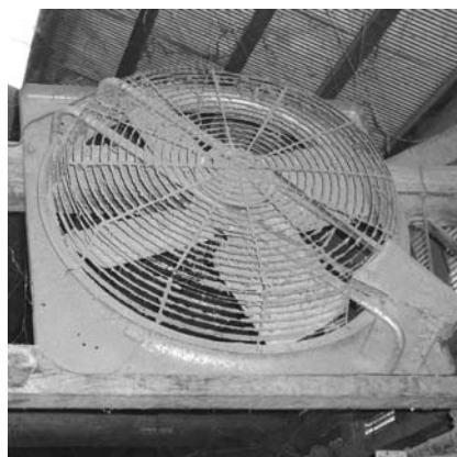
⑦換気扇 ベルト式 4台
